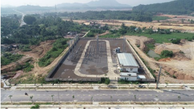
แหล่งจ่ายไฟ สถานีไฟฟ้า 110kV
